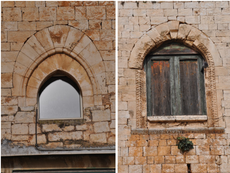
Fig. 4 La monofora e la bifora presenti sul prospetto orientale della torre di sudest del castello di Conversano (Foto di Paolo Perfido).
